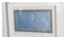
Control PLC de pantalla táctil
